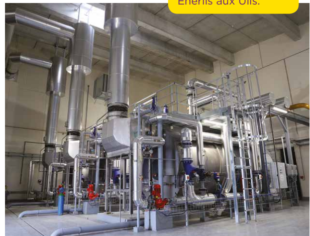
Chaufferie biomasse Enerlis aux Ulis.
